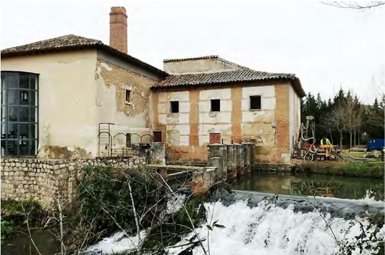
2. Estado del Molino antes de las intervenciones. Foto cedida por Raíz Cimentaciones.
