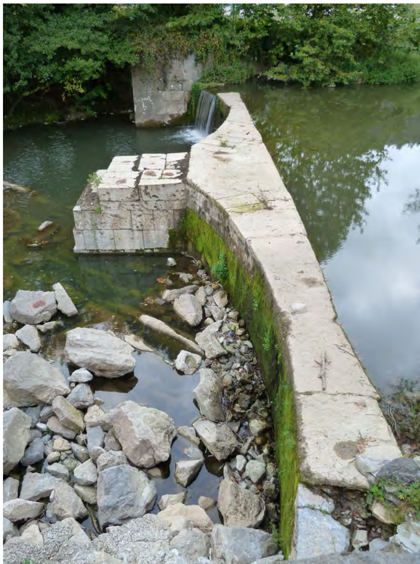
Fig. 1. Presa de Oxillain Barroeta. Estado en 2015. Presenta falta de losas en la coronación en ambos extremos. En ellos puede producirse un progresivo desprendimiento y pérdida de mampostería y sillería originando a medio plazo la destrucción de la obra. El resto de la estructura se encuentra en buen estado.
