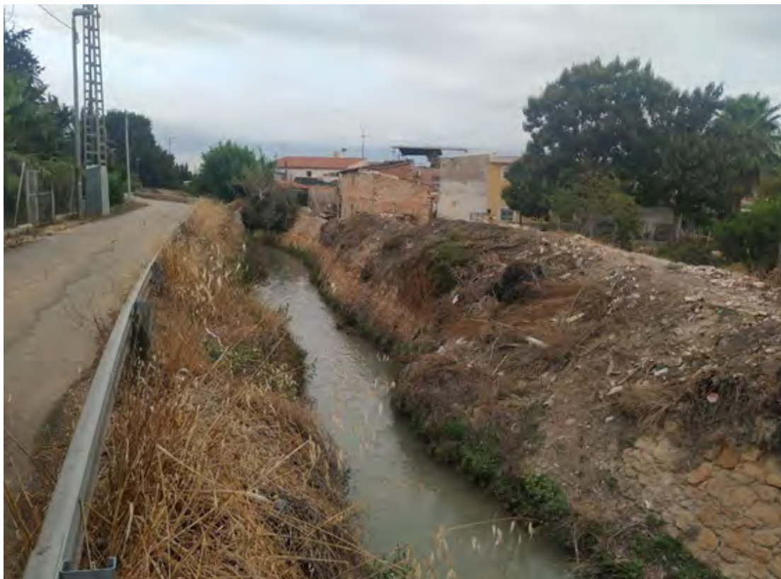
Foto 4. Abandono, derrumbes y suciedad en la Acequia Mayor de Barreras, en la zona próxima al acueducto del Canal de Torres. Asociación AJVA – CEP Molino de Oliver.
