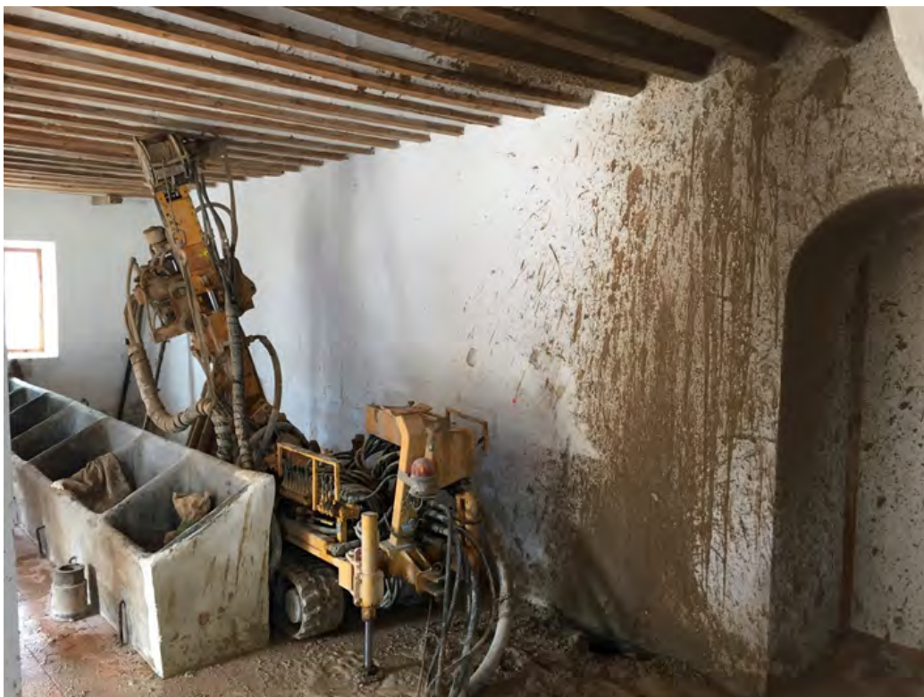
3. Ejecución de micropilotes en el muro de carga interior. Fotografía tomada por los autores.
