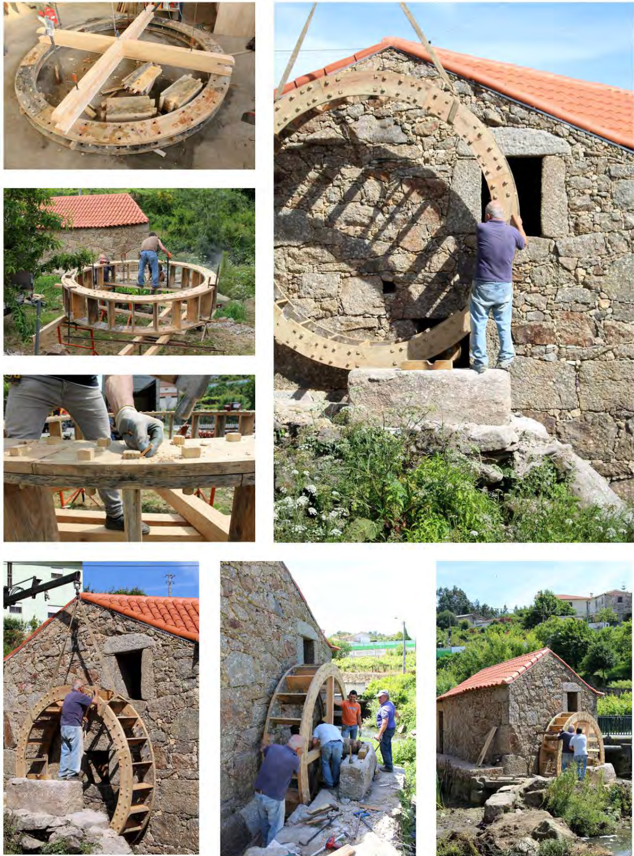
Imagem 6. Proceso de ejecución, montaje e instalación de la Rueda Hidráulica Vertical del Molino São Marçal. R. Bruno Matos, (2019).
