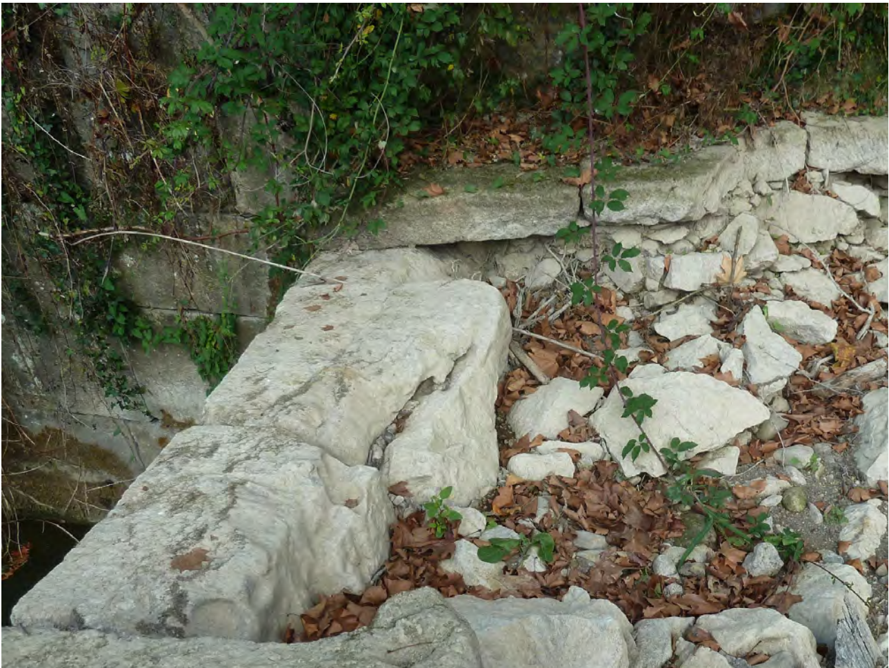
Fig. 3. Oxillain, arco derecho, estado 2014. Falta de las losas y del macizado. Asoman las tablas que tras la construcción se colocó a modo de forro sobre el talud aguas arriba para protegerlo hasta el endurecimiento de la cal. Estas tablas deben quedar visibles y exentas tras la reposición de la mampostería. (fotografía del autor)
